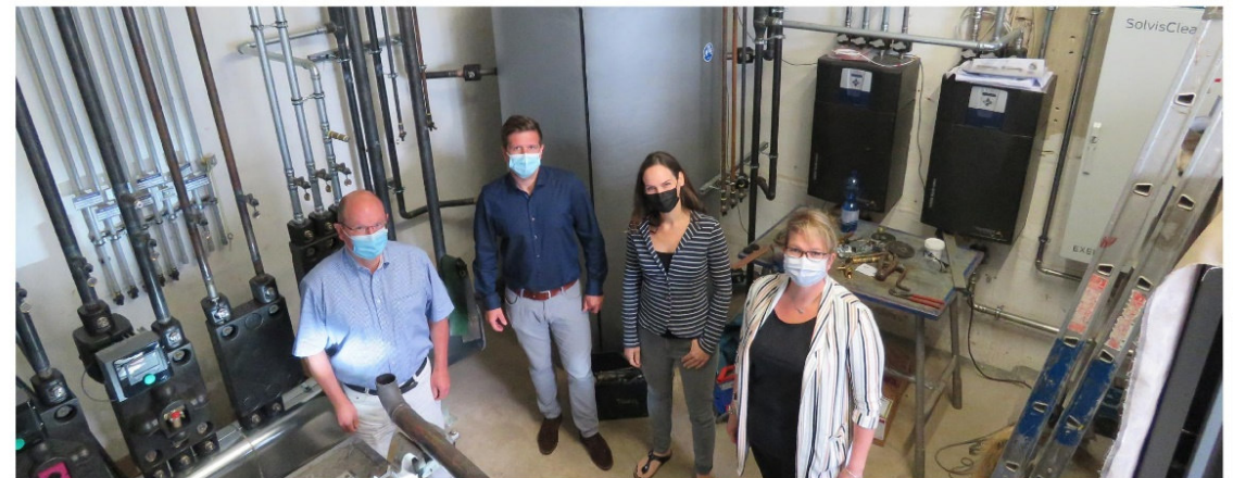
Nehmen den Fortgang der Umbauarbeiten in Auenschein: Nils Althoff, Energiemanagement des Landkreises (v.li.), Hendrik Hochmann, Kirchner Gebäudetechnik, Verena Michalek, Klimaschutzagentur Weserbergland, und Janina Dornbusch, Hochbauamt des Landkreises.
