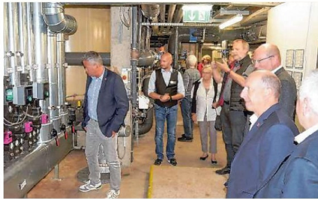
Unter fachkundiger Führung wurden den Gästen die technischen Einrichtungen des Modellprojekts in den Kellerräumen der Sporthallen und der Schwimmhalle veranschaulicht.
